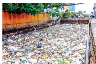
ごみが水の流れを妨げ、また ポンプを閉塞するため洪水が 生じる(June 2018 ※2 )
