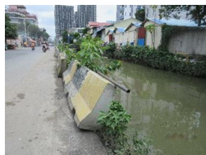
コンクリート壁の傷み
