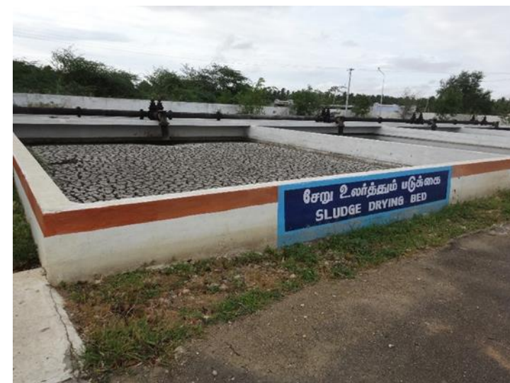
汚泥天日乾燥床
