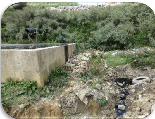
写真 1-3 浸出水は貯留槽だけでは 処理できず水質汚濁の原因になる
