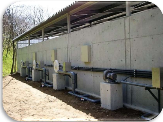
写真 5-1 エアレーション用送風機
