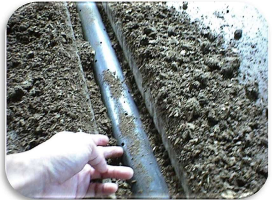
写真 5-2 エアレーションパイプ
